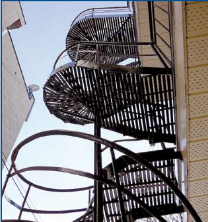
استخدام السلالم الخلفية أفضل وسيلة لمغادرة المبنى عند وقوع الحريق
